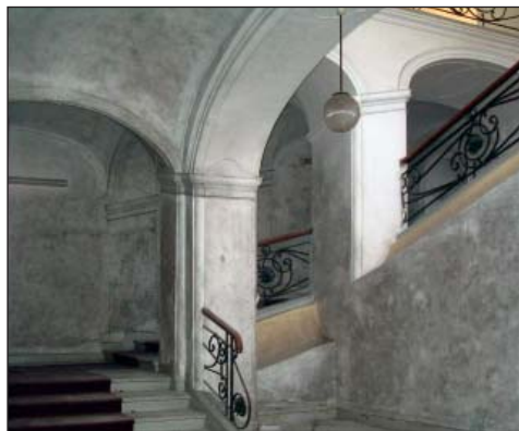
Neutěšený stav interiéru – schodiště v přízemí v r. 2014, foto město Paskov
